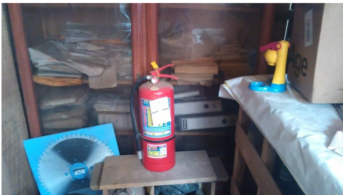
Fotografía 2. Equipo contra incendio no operativo (vencido)
